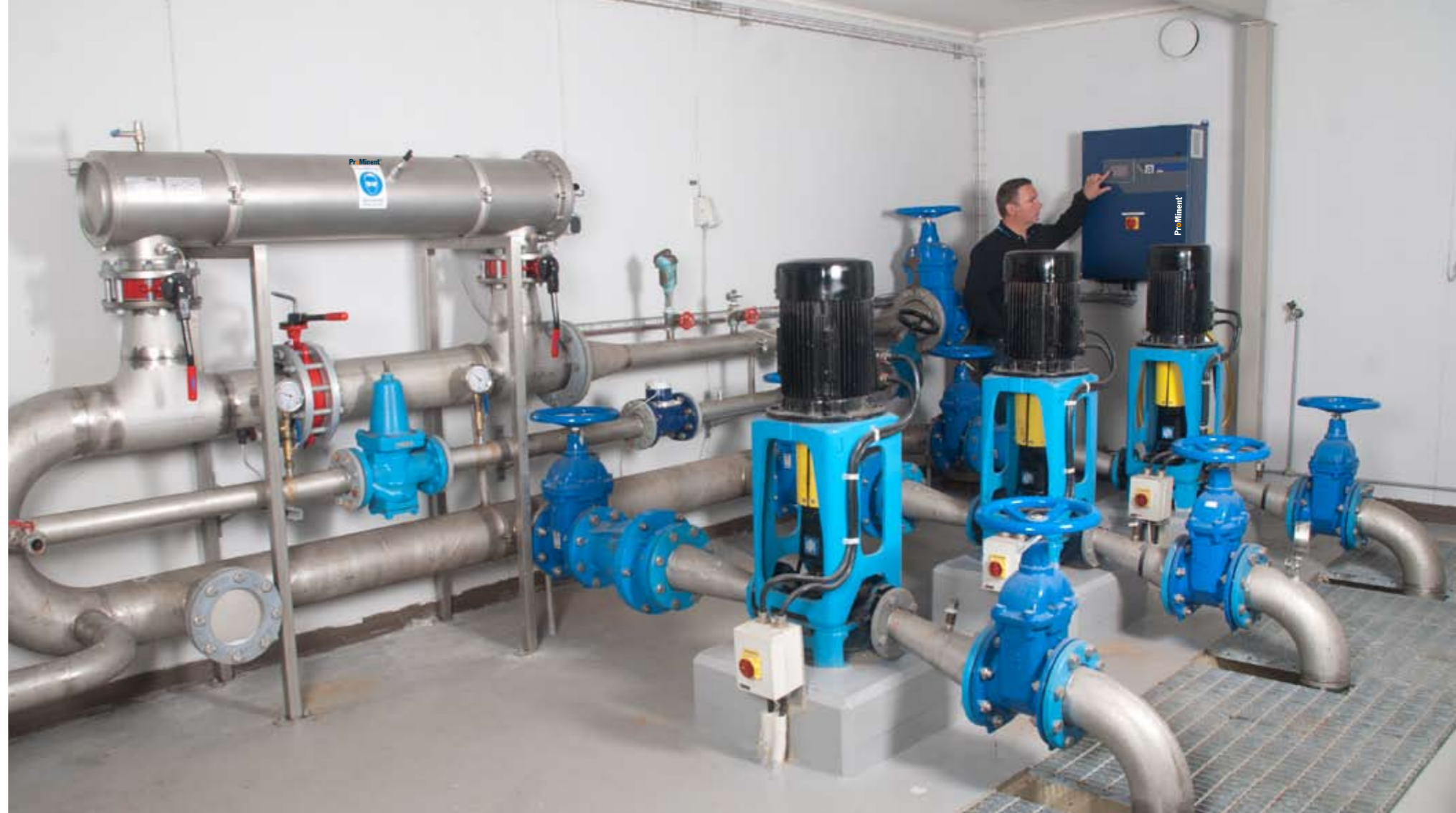
VA-projektledare Ingemar Karlsson framför styrskåpet för UV-aggregatet på va-verket i Ale
